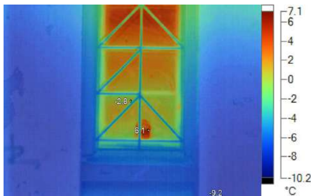
Fotografija 8.33. Termovizijska snimka s vanjske strane na sjevernu fasadu, Broj snimke: IR 20121210_0090.is2 (12.12.2012., 13:14)
