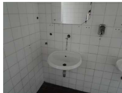
Slika 8.30. Zgrada JU OŠ Saburina u Sarajevu, zatečeno stanje, (a) kupaonica za učenike, (b) tuš zona za učenike, (04.12.2012.)
