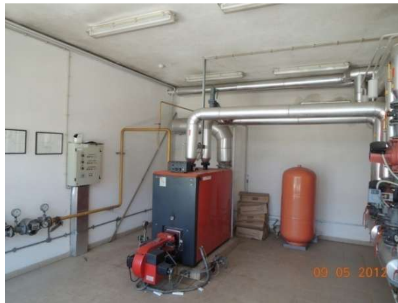
Fotografija 8.54. Zgrada JU OŠ Skender Kulenović u Sarajevu, kotlovnica (09.05.2012.)
