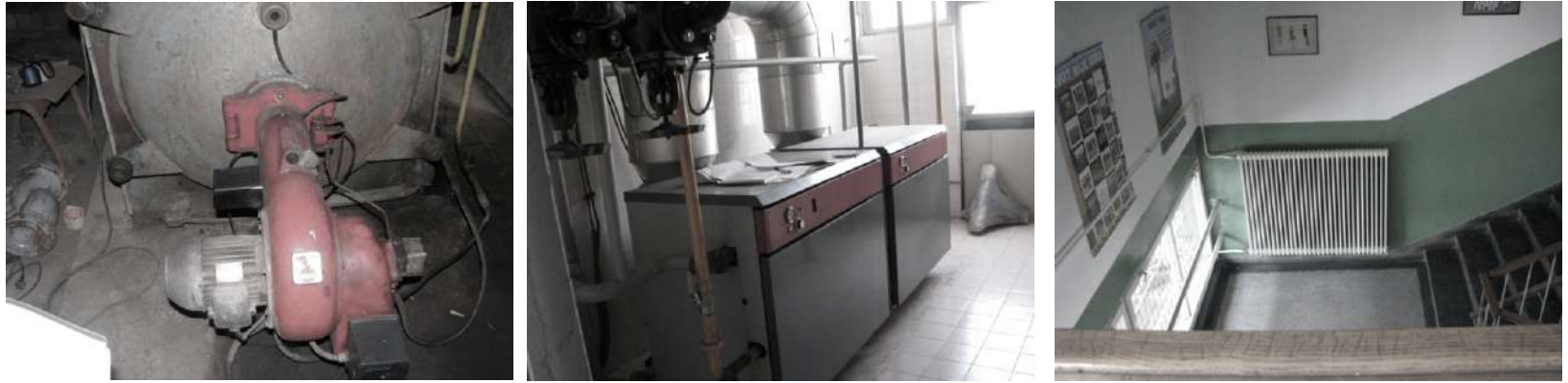
Fotografija 8.43. Zgrada JU OŠ Hasan Kikić u Sarajevu, (a) sekundarna kotlovnica, (b) primarna kotlovnica (24.02.2010.)
