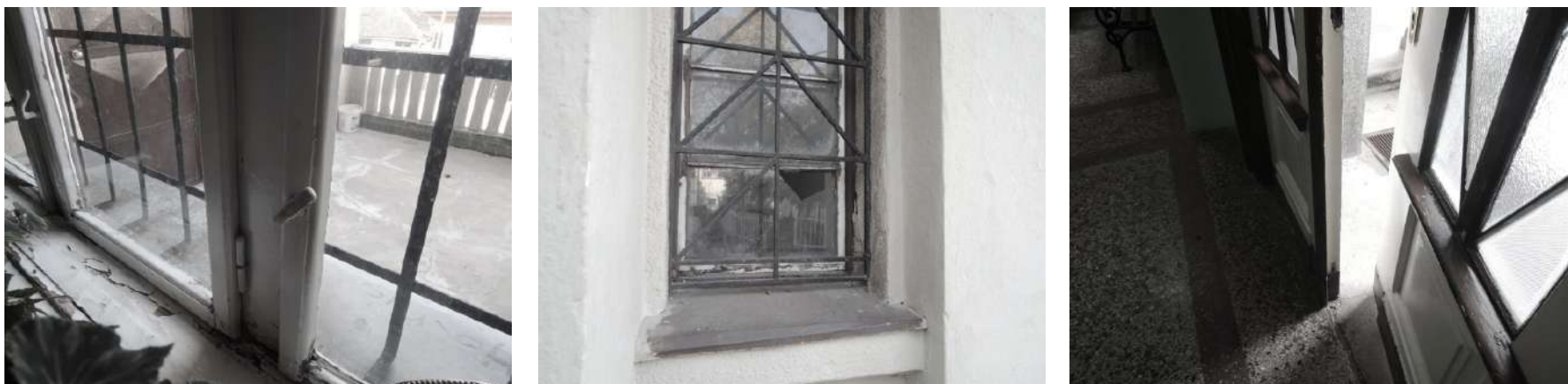
Fotografija 8.29. Zgrada JU OŠ Saburina u Sarajevu, (a) vanjski otvori TIP2, oštećenja i (b,c) vanjski otvori ulazna vrata, (04.12.2012.)
