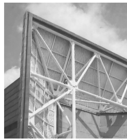
[140] Lidumil Alikalčić i Dušan Đapa: Kulturno-sportski kompleks „Zetra“, Sarajevo, 1982. // Lidumil Alikalčić and Dušan Đapa: Cultural and Sports Complex "Zetra", Sarajevo, 1982
